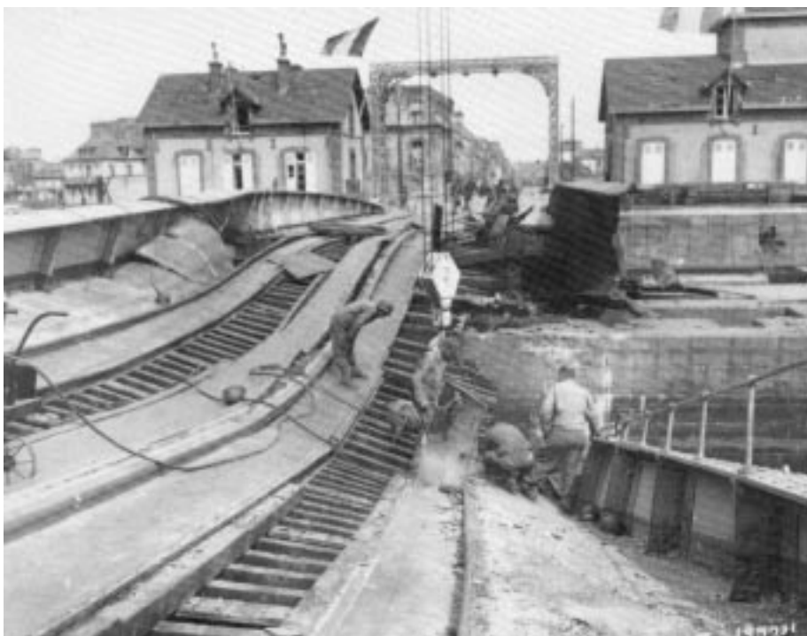
Le pont tournant vient de s'effondrer dans l'écluse. Cette photo a été prise par Robert Capa, fondateur en 1947 de la célèbre agence Magnum avec Henri Cartier-Bresson. Robert Capa est décédé le 25 mai 1954 au Vietnam en sautant sur une mine.
